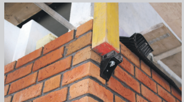
▲ Stap 4. Om de profielen te kunnen optoppen wordt een kunststof muurplug ingemetseld in de lintvoeg. Op deze muurplug kan later een hoeksteun met verstelbare piramide worden vastgezet.
